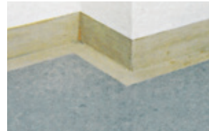
Pavimento completamente pegado a la solera con un espacio a la pared
